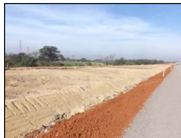
Foto 5. Camada de areia sobre os resíduos.
