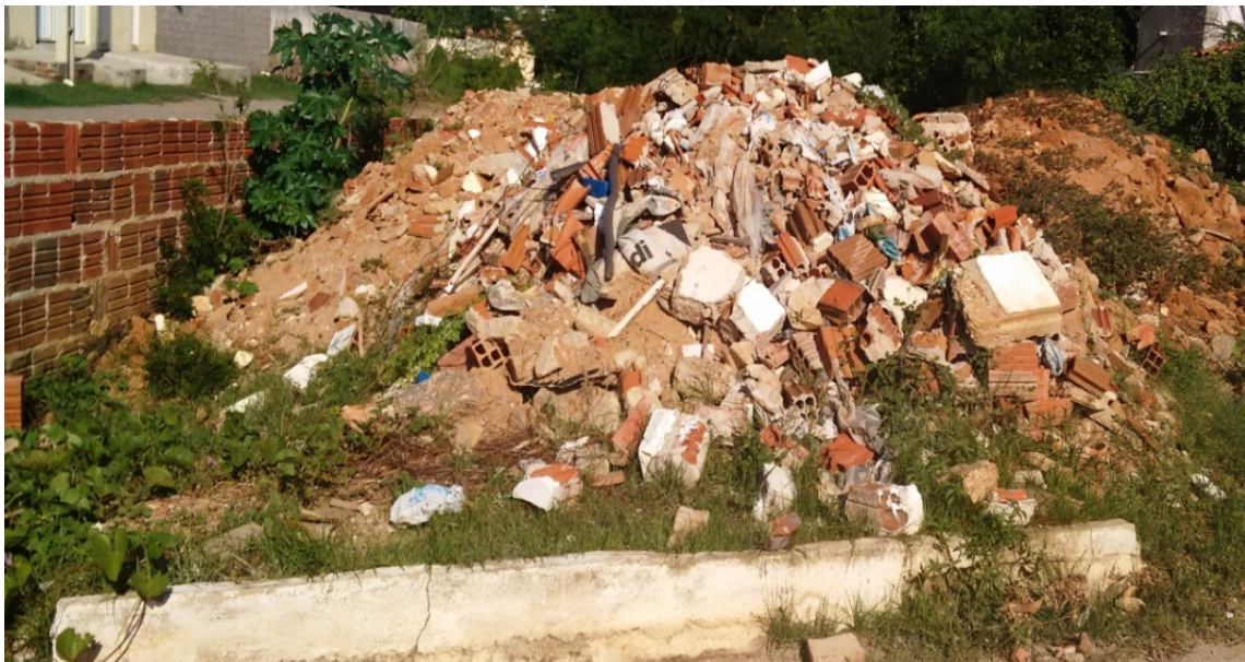
Figura 2. Resíduos acumulados em obra.
