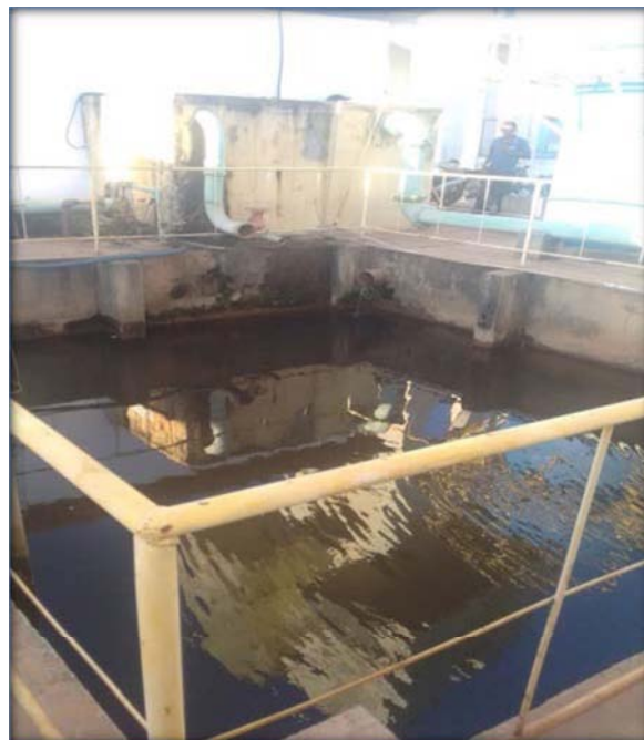
Figura 3: Tanques de Reaproveitamento. Embasa, 2016.
