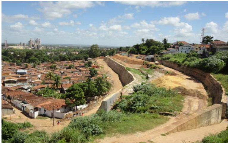
Figura 3 – Área de risco na comunidade Saturnino de Brito com execução das obras de contenção. Abril/2015.
