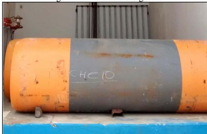
Figura 4: Tubos de cloro gasoso
