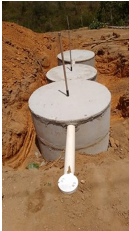
Fig. 1: Fossa séptica biodigestora
