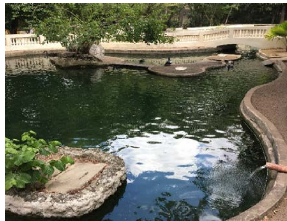
Imagem 2 – Tubulação que alimenta o Lago dos Patos.
