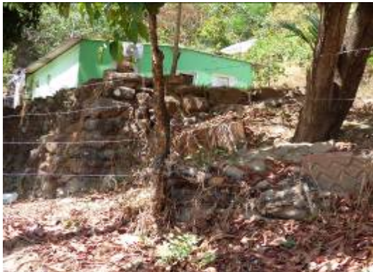
Figura 2 - Enrocamento de terreno na encosta Serra Azul Fonte: Foto da primeira autora (2015).
