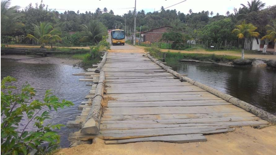
Figura 4 – Ponto 03, situado na ponte da Rua São Miguel em Baía da Traição-PB.
