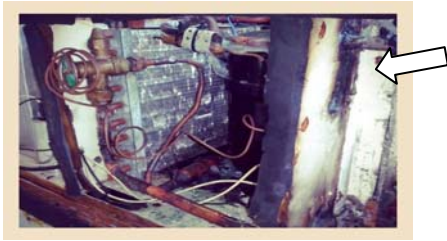
Figura 7. Formação de gelo na superfície da válvula de expansão encontrada durante o experimento de Maia (2014).
