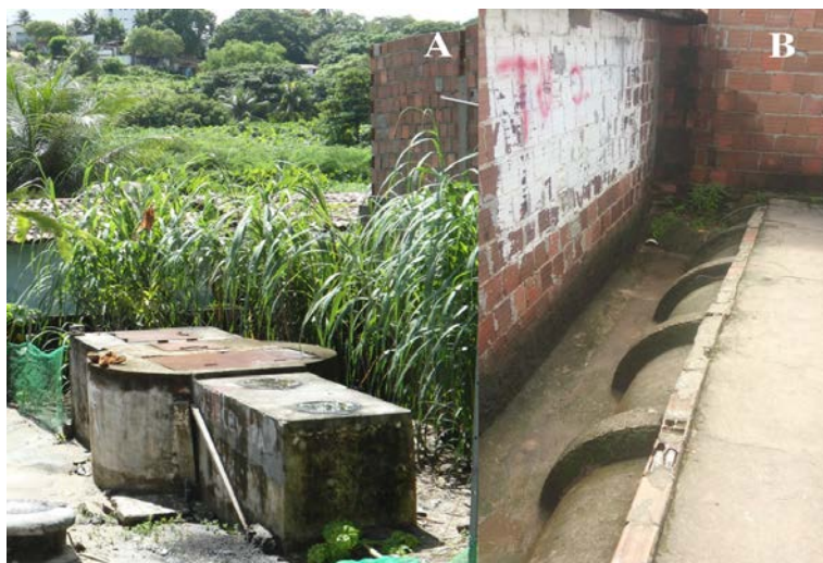
Figura 3. - A) Estação de tratamento. B) Tubulação que faz parte do conjunto da estação de tratamento. Fonte: Dados da pesquisa, 2017.
