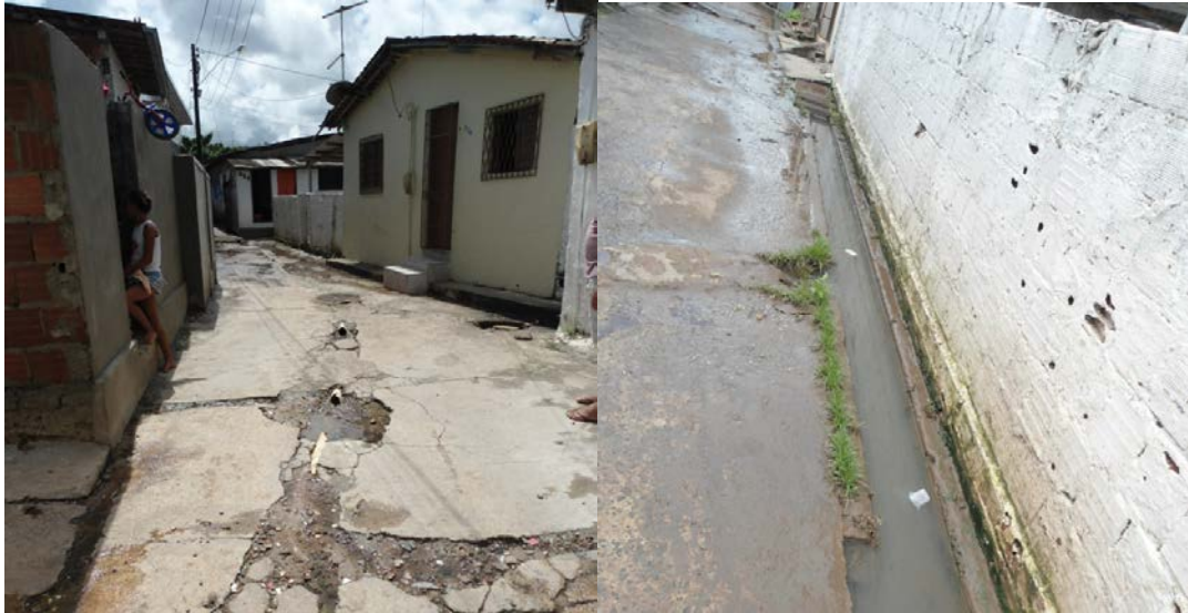
Figura 2. Esgotos a céu aberto nas ruas Fonte: Dados da pesquisa, 2017.
