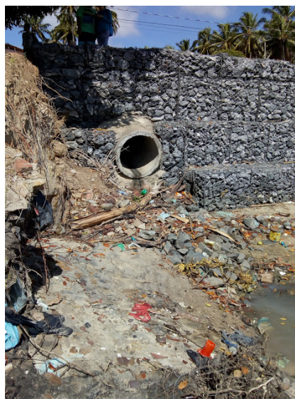
Figura 9. Saída de efluente à margem de rio. Fonte: Autores (2017).
