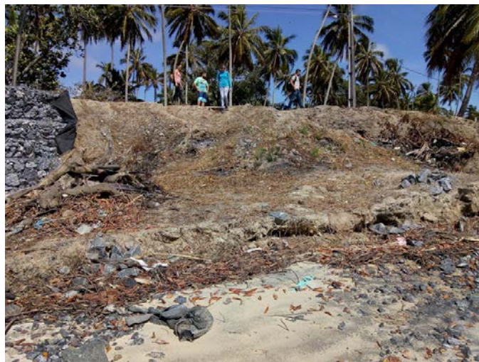
Figura 3. Processo erosivo à margem de rio. Fonte: Autores (2017).
